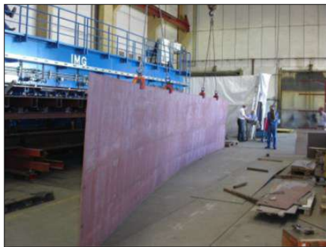
Figura 2. Primer panel de 12m soldado en las instalaciones de AKER YARDS Rostock en 2005.
